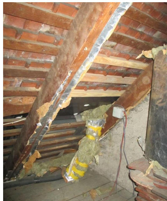
Abbildung 14: Die Dachdämmung wurde für die Kollektormontage abgebaut aber nicht mehr montiert. Ein Stück der Dachdämmung wurde für die provisorische Dämmung der Solarleitung verwendet.
