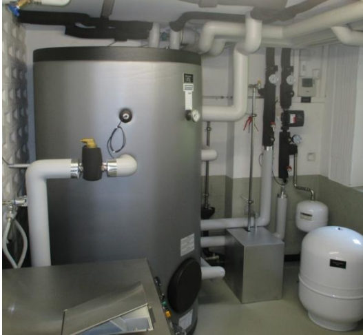
Abbildung 5: Fachtechnisch einwandfreie Installation und Dämmung einer solarthermischen WW-Vorwärmungsanlage.
