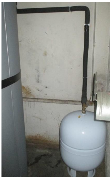
Abbildung 9: Das Ausdehnungsgefäß muss zum Schutz der Membranen über eine Auskühlstrecke verfügen. Hier wurde die Verbindungsleitung fälschlicherweise gedämmt.
