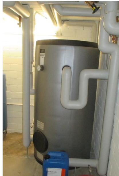
Abbildung 6: Fachtechnisch einwandfreie Siphonierung und Dämmung der Warmwasserleitung am Solarspeicher.
