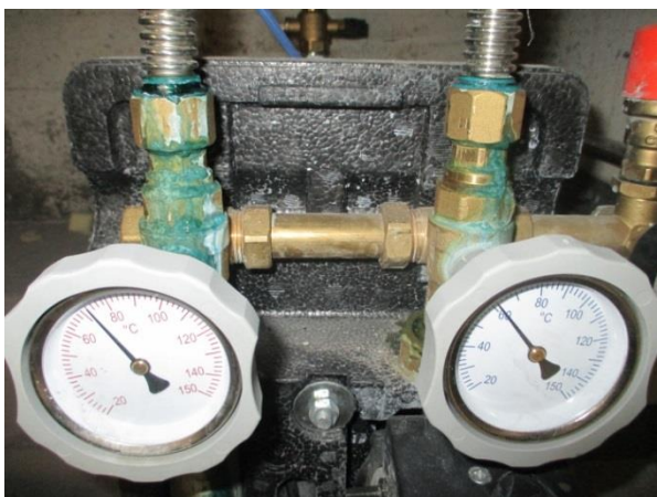
Abbildung 13: Starke Verkrustung an der Solargruppe auf Grund seit längeren bestehender Leckage.
