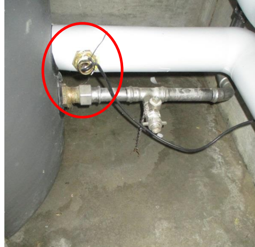
Abbildung 17: Speicherfühler der Solaranlage müssen wirklich die Temperatur des unteren Speicherwassers wiedergeben und dürfen nicht am Solar-Rücklauf montiert werden da sonst die Solaranlage fälschlicherweise einschaltet.
