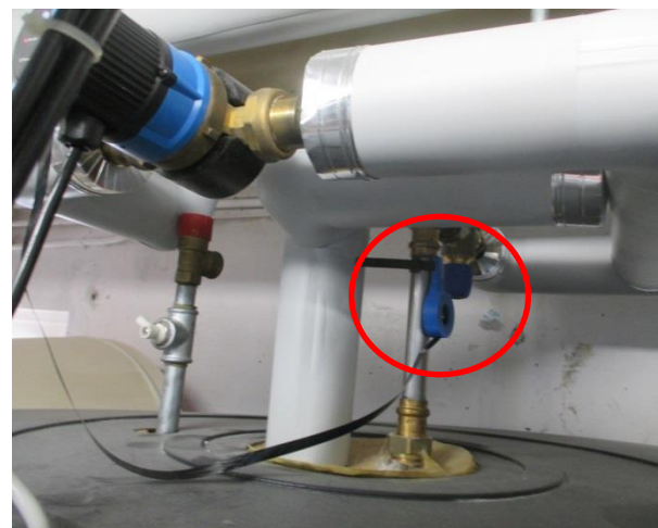
Abbildung 10: Der ausziehbare Temperaturfühler von WW-Zirkulationspumpen darf nicht an einer Stelle sein an der 24h Stunden 60°C vorliegen durch thermische Zirkulation. Die selbstlernende Pumpe läuft so 24 Stunden.
