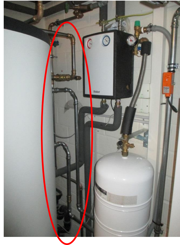
Abbildung 12: Ein WW-Speicher mit hochwertiger EPS - Dämmung verliert seine guten Dämmeigenschaften wenn die Anschlüsse und Leitungen nicht gedämmt sind.
