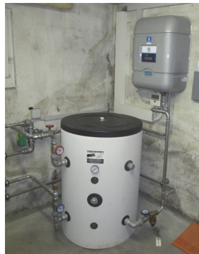
Abbildung 6: Wärmepumpe ohne Dämmung der Leitungen.
