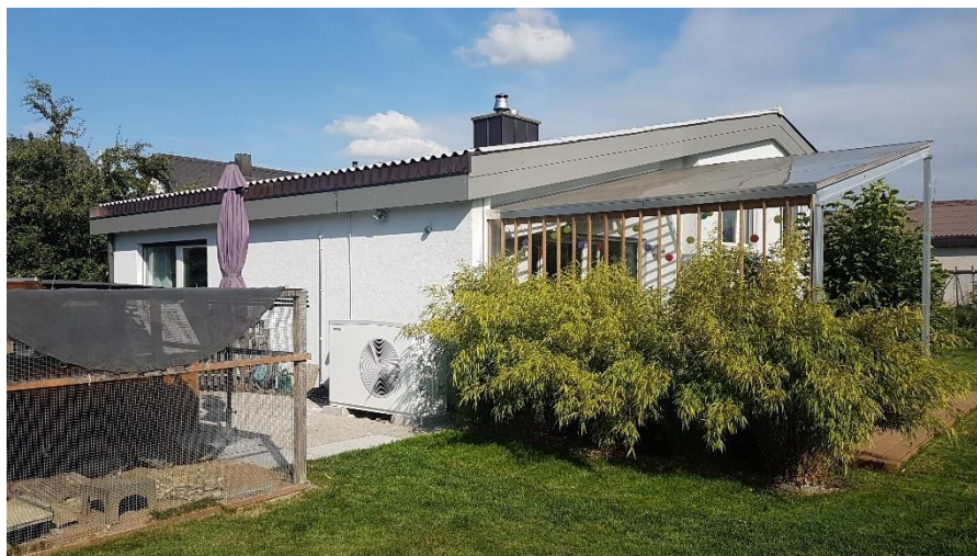
Abbildung 5: Typische Installation einer aussen aufgestellten Wärmepumpe. Quelle: Heizungsmacher AG.
