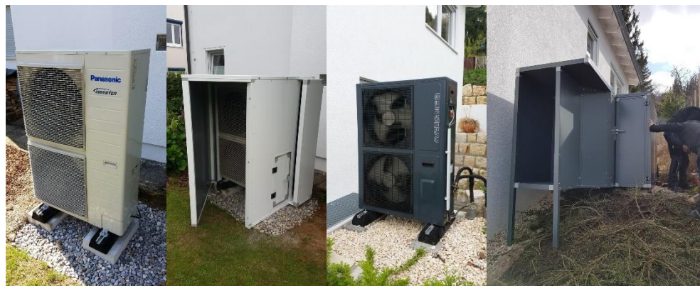
Abbildung 8: Beispiele von nachträglichen Schallschutzmassnahmen. Links: Wärmepumpe vor und nach der Einhausung. Rechts: Wärmepumpe an einem ungünstigen Standort, nachträglich mit Schallschutztunnel entlang der Hauswand. Quelle: Schäfer GmbH
