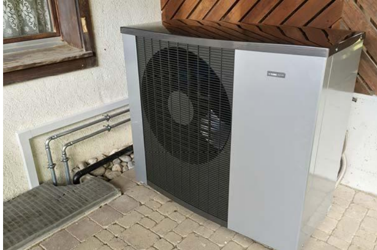
Abbildung 4: Beispiel einer aussen aufgestellten Kompaktanlage der Firma NIBE. Quelle: Haustechnik Oppliger AG, Othmarsingen.
