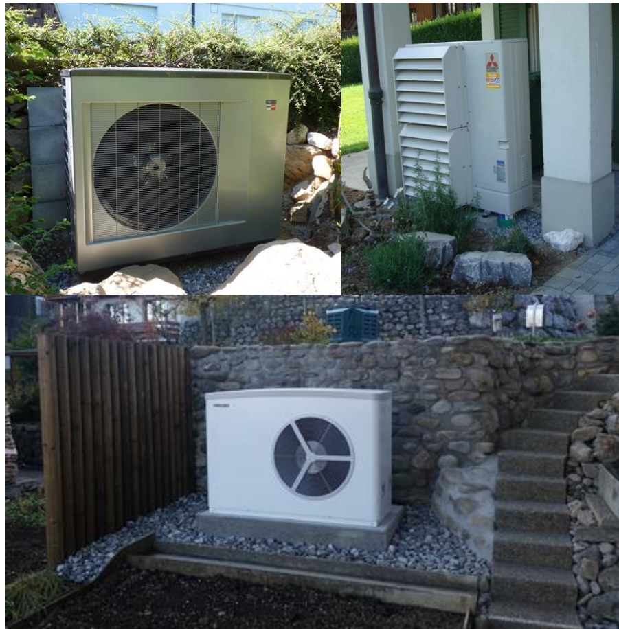
Abbildung 10: Lösungen zur visuellen Integration von Ausseneinheiten. Quelle: BZS Heizung-Sanitär AG, Spiez.
