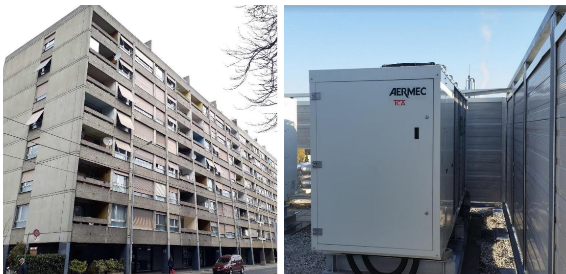
Abbildung 10: Ansicht Gebäude; Dachaufgestellte Wärmepumpe mit Schallschutz-Einfriedung. Quelle: SIG-éco21
