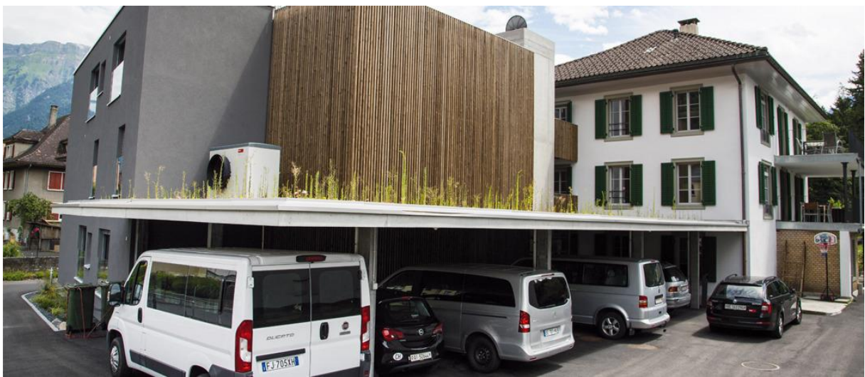
Abbildung 22: Aussenaufgestellte Wärmepumpe auf dem Carport-Flachdach. Quelle: Hoval.
