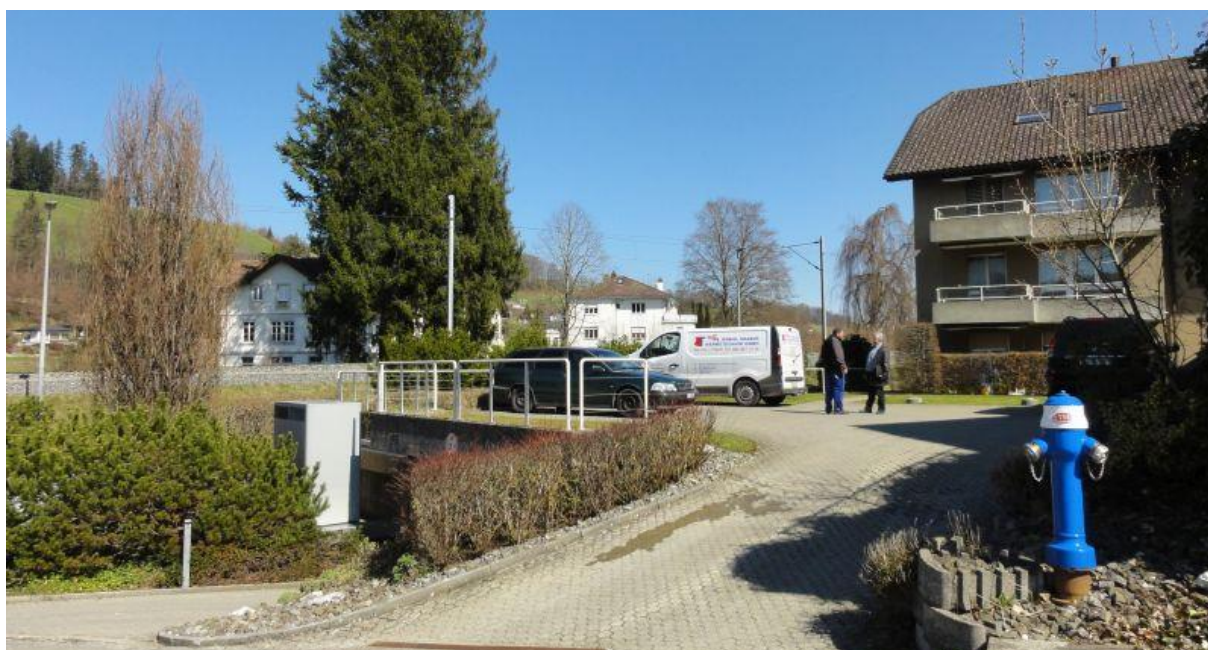
Abbildung 6: Aussenaufgestellte Wärmepumpe, «versteckt» neben der Tiefgarageneinfahrt, mit der Liegenschaft im Hintergrund. Quelle: Märki, Bucher & Perch-Nielsen (2018).
