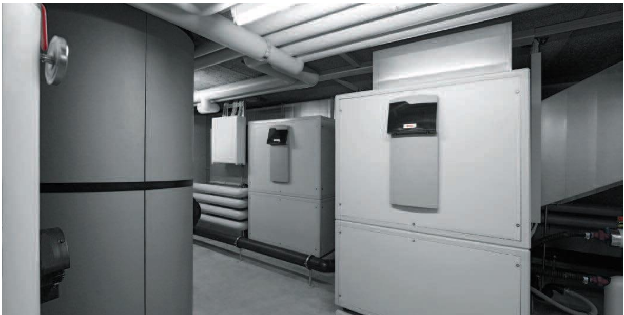
Abbildung 16: Aufgeräumter Technikraum mit zwei innenaufgestellten Wärmepumpen. Quelle: Elcotherm AG
