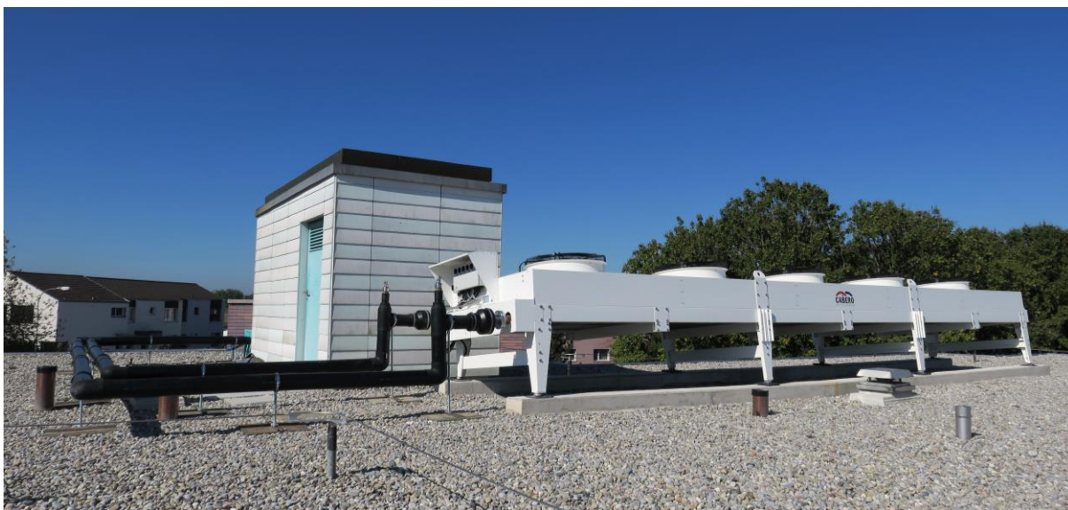
Abbildung 4: Flachdach mit Rückkühler und Wasser-Glykol-Kreislauf. Quelle: TBF + Partner AG.
