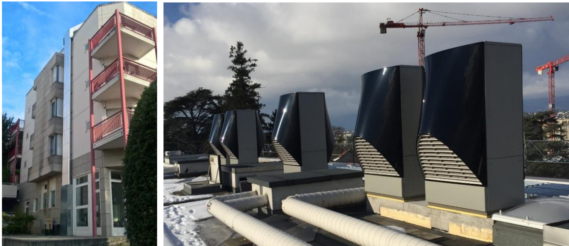
Abbildung 11: Ansicht Fassade mit Aufputz-Leitungen; Wärmepumpen auf dem Dach. Quelle: SIG-éco21
